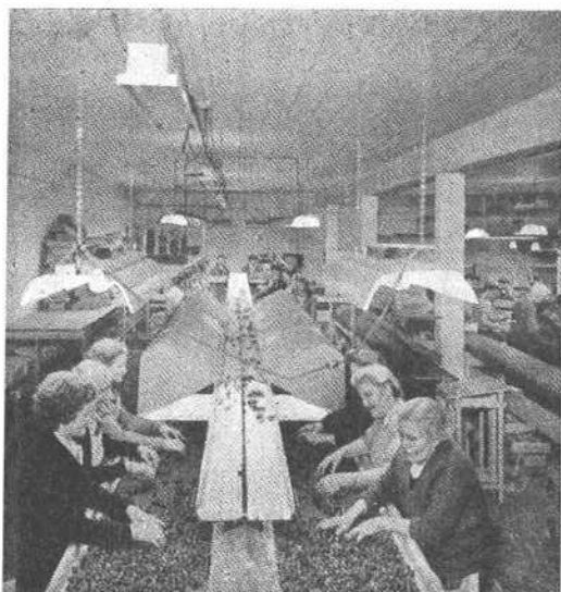
FIG. 11. — Ranges de lampes germicides installées au-dessus d'une table de triage de fruits rouges. (Campbell's book.)
