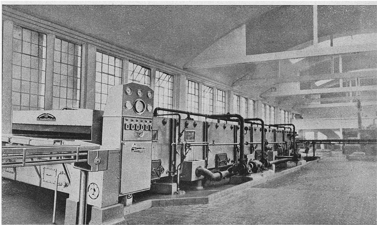
FIG. 5. Pasteurisateur Bayard. Installation Gangloff réalisée à la Brasserie de Cronenbourg.
