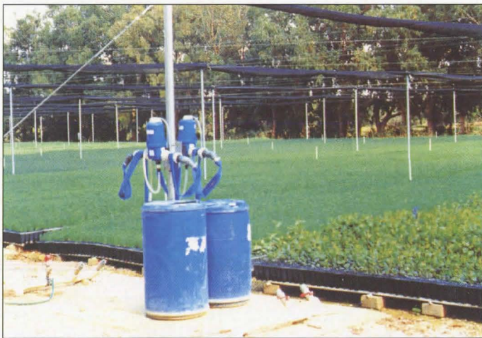
Photo 8. La fertilisation est assurée à l'aide de deux injecteurs de type « Dosatron » installés en parallèle avec la conduite principale d'irrigation. Le système est hydraulique et autonome et ne nécessite pas une installation électrique. Le taux d'injection de la solution fertilisante peut être ajusté entre 0,2 et 2 % (pépinière pilote de Oued El Bir, Tunisie) (cliché Lamhamedi).
