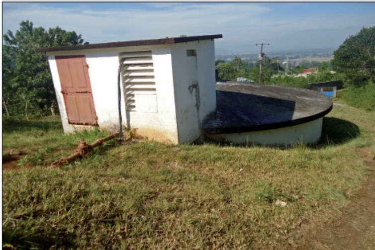
Photo 2. Station de captage et d'épuration d'eau de la compagnie en charge du réseau de distribution de l'eau potable (JIRAMA) Photo M. Rakotondrabe.
