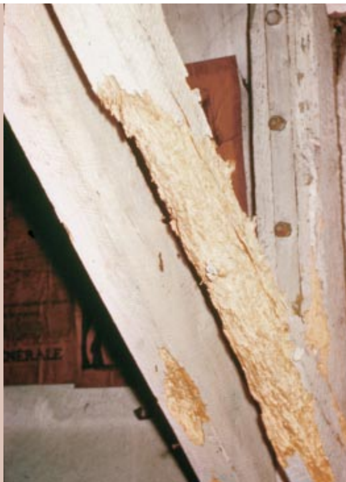
Photo 5. Charpente endommagée par les termites. Photo D. Fouquet.
