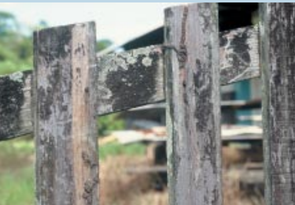
Photo 12. Altérations fongiques sur du grignon utilisé en extérieur, en Guyane. Fungus damage to exterior louro red, Guyana. Photo D. Fouquet.
