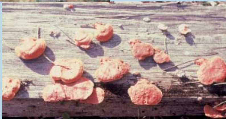
Photo 13. Attaque de pourriture fibreuse sur un élément de traverse, en Guyane. Stringy rot on a cross-tie piece, Guyana. Photo D. Fouquet.
