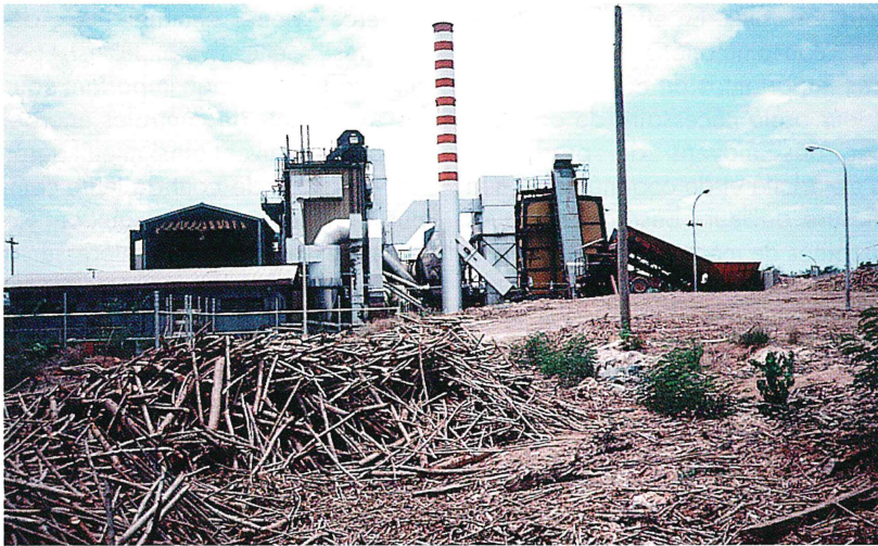
Centrale électrique « Dendrothermal » construite aux Philippines par ALSTHOM.
